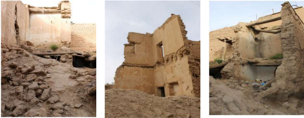
Fig 12: Images montrant la détérioration des éléments structurels des anciens bâtiments du Ksar, suite aux différents effets de l'environnement.
