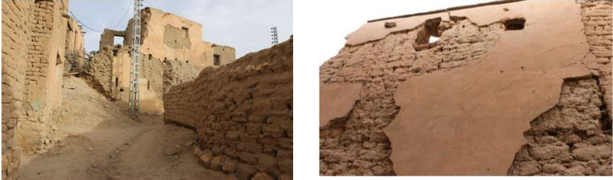
Fig 16: état des façades des murs
