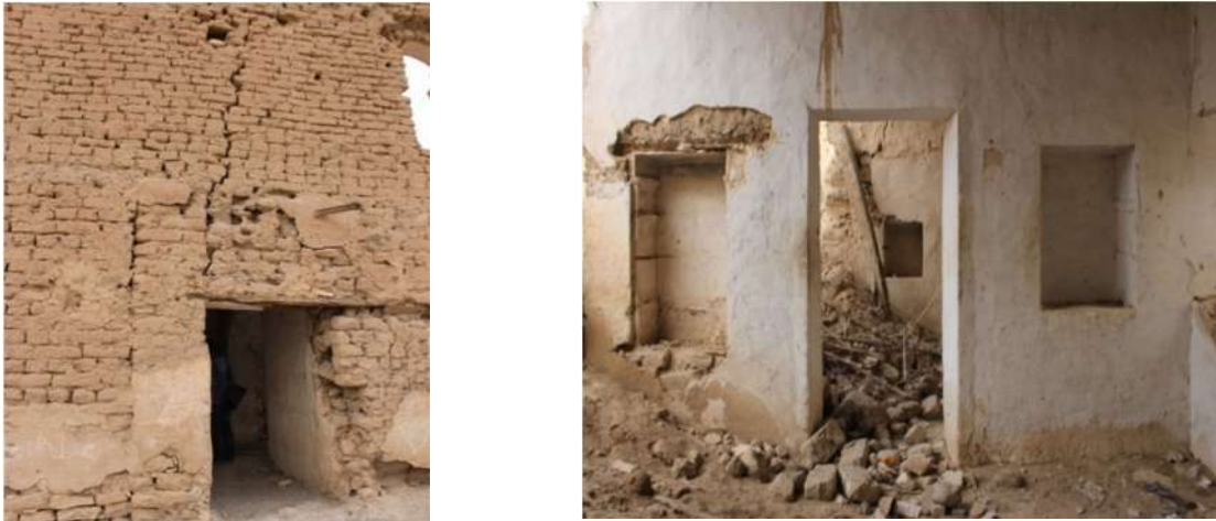
Fig 18 : Exemple de détérioration des façades murales, (mur, portes, niches et des toits)
