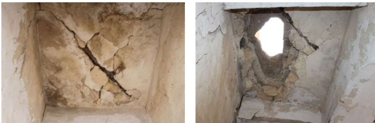
Fig 19 : Exemple de fissuration des toits récent en raison de l'incompatibilité des matériaux.
